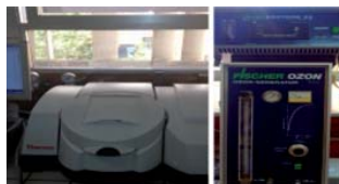
Reactor con equipo de ozonización - UV-VIS on line
